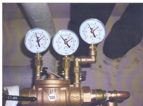
Figur 8.4 Billede af TBS ventil monteret med aflæsningsmanometre således, at det er muligt direkte at kontrollere ventilens funktion
